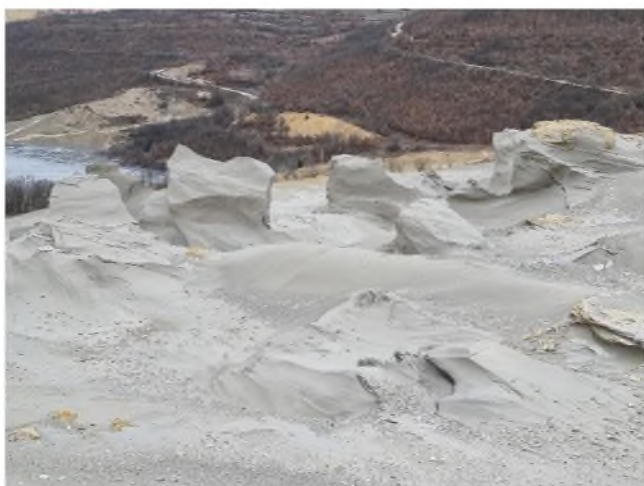
Slika br.27: Erozivne strukture na brani i jalovišta
