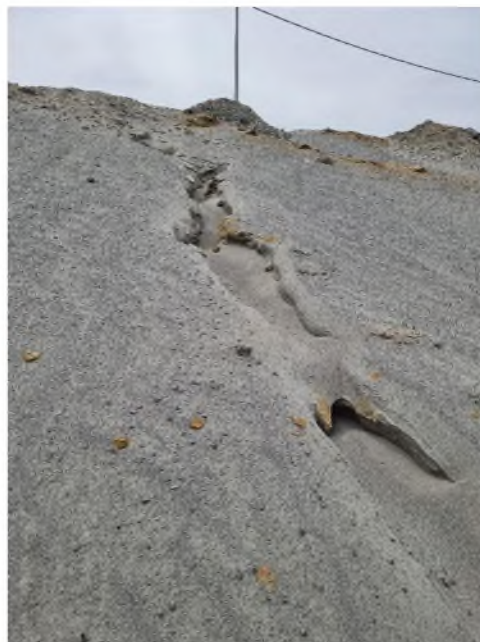
Slika br.28: Erozivne strukture na brani i jalovišta
